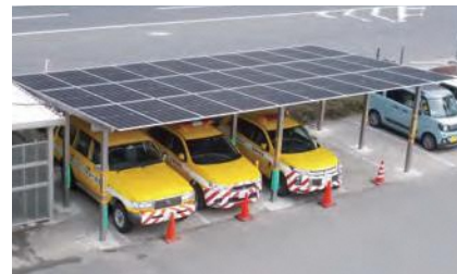
東体育館 カーポート型太陽光パネル
