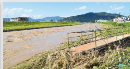
伊佐津川の境谷橋が流失(伊佐津地区)
