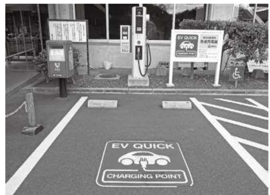
市役所本庁前の急速充電器
