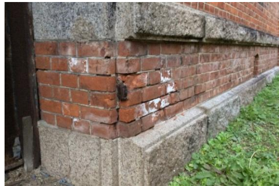
図 2. 1. 126 7号棟東面出入口 煉瓦破損状況
