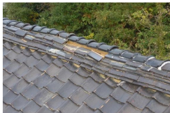
図 2.1.140 7号棟 棟破損部
