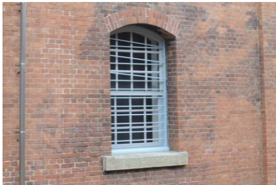
図 2.1.95 4号棟一階窓 鉄格子破損状況
