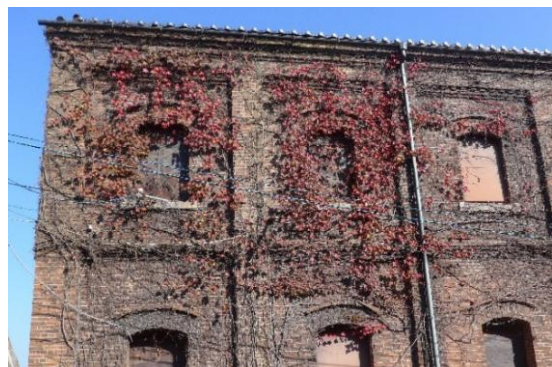
図 2. 1. 128 8号棟南面 植物繁茂状況
