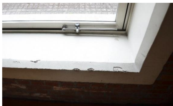
図 2.1.78 2号棟窓枠漆喰 破損状況
