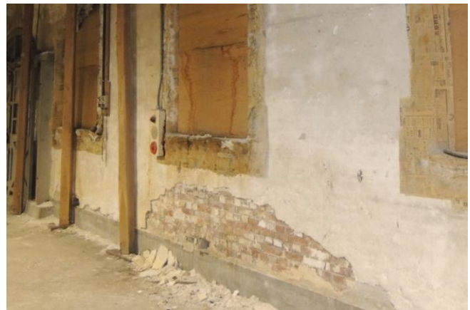
図 2.1.136 6号棟 一階漆喰剥落
