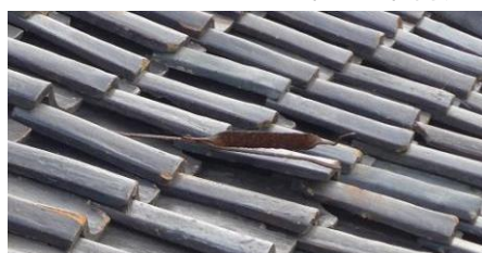
図 2.1.141 8号棟 雪止め金物痕跡
