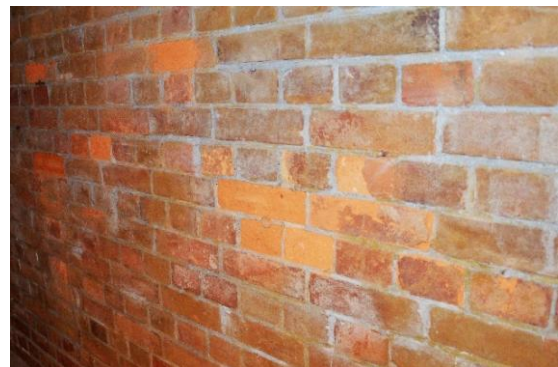
図 2.1.66 4号棟内壁煉瓦 表面剥離
