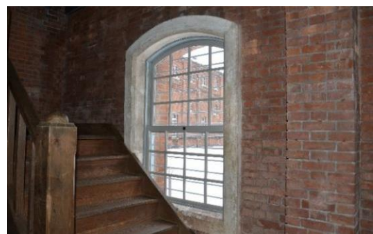
図 2.1.79 4号棟窓枠漆喰 汚れあり
