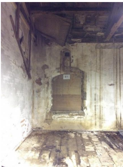
図 2.1.135 8号棟 二階床板腐食
