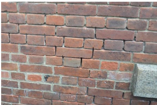
図 2.1.65 2号棟外壁煉瓦 目地空隙
