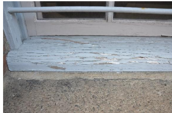
図 2.1.96 3号棟一階窓 窓枠塗装破損状況
