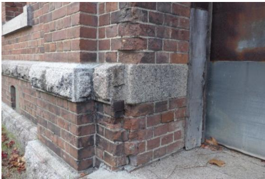
図 2. 1. 125 8号棟南面出入口 煉瓦破損状況
