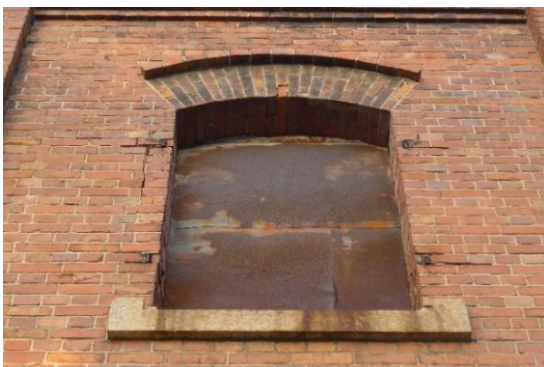
図 2. 1. 127 6号棟南面窓廻り 煉瓦破損状況
