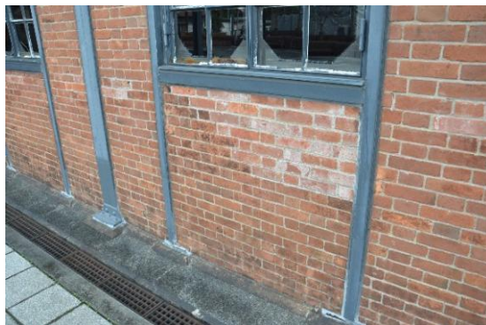
図 2.1.23 煉瓦外壁 変色部分
