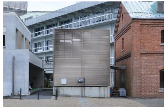
図 3.1.28 区域B 室外機置場
