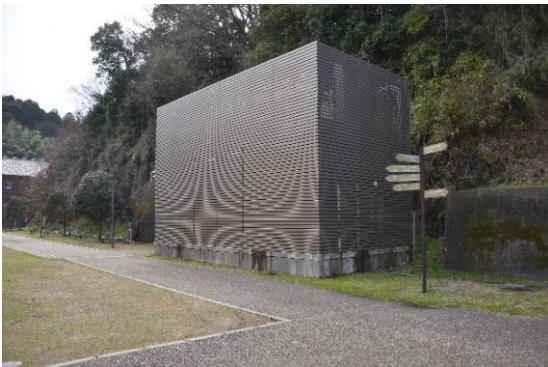
図 3.1.27 区域B 受変電設備
