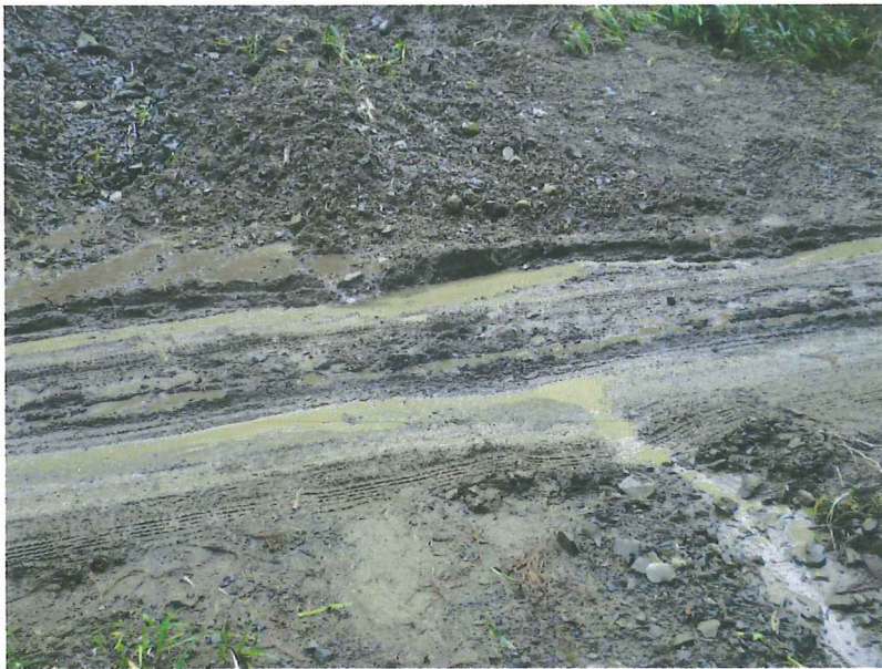
施工前 湧水が林道を流れて洗掘して いる状況
