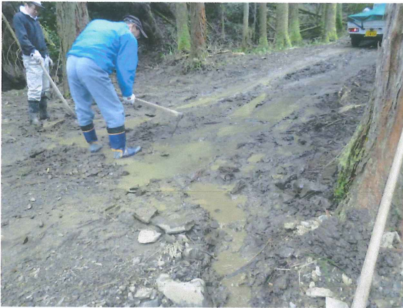
施工前 湧水が林道を流れて洗掘している状況
