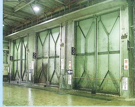
収集車が、ごみピットにごみを投入する場所です。
