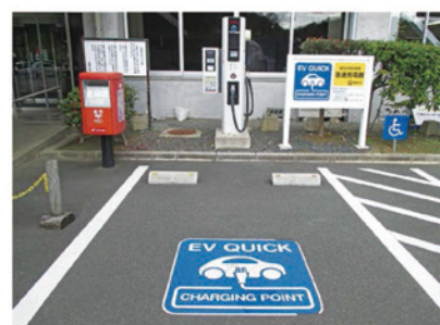
市役所本庁前の急速充電器
