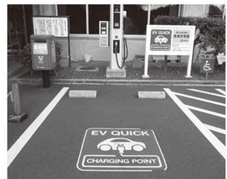
市役所本庁前の急速充電器
