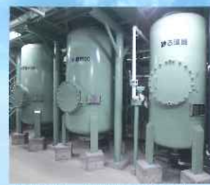
▲砂ろ過・活性炭吸着設備
