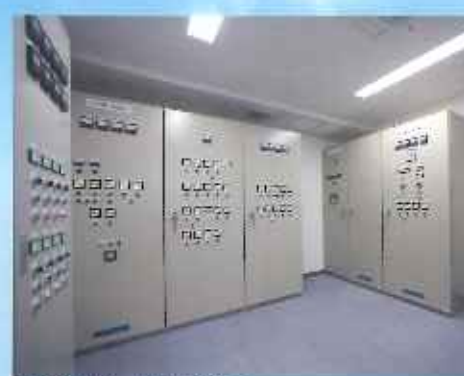
▲監視・操作盤室
