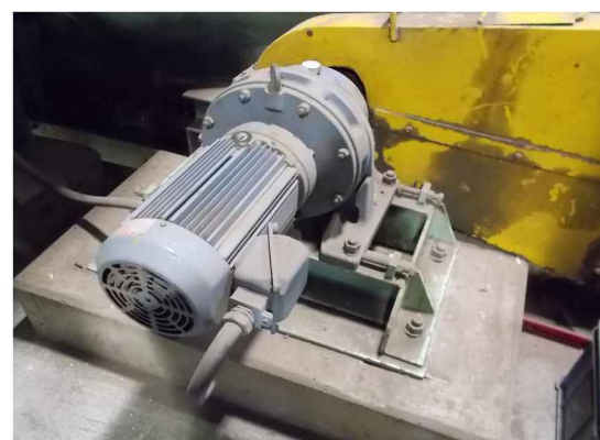
コンベヤ用電動機
