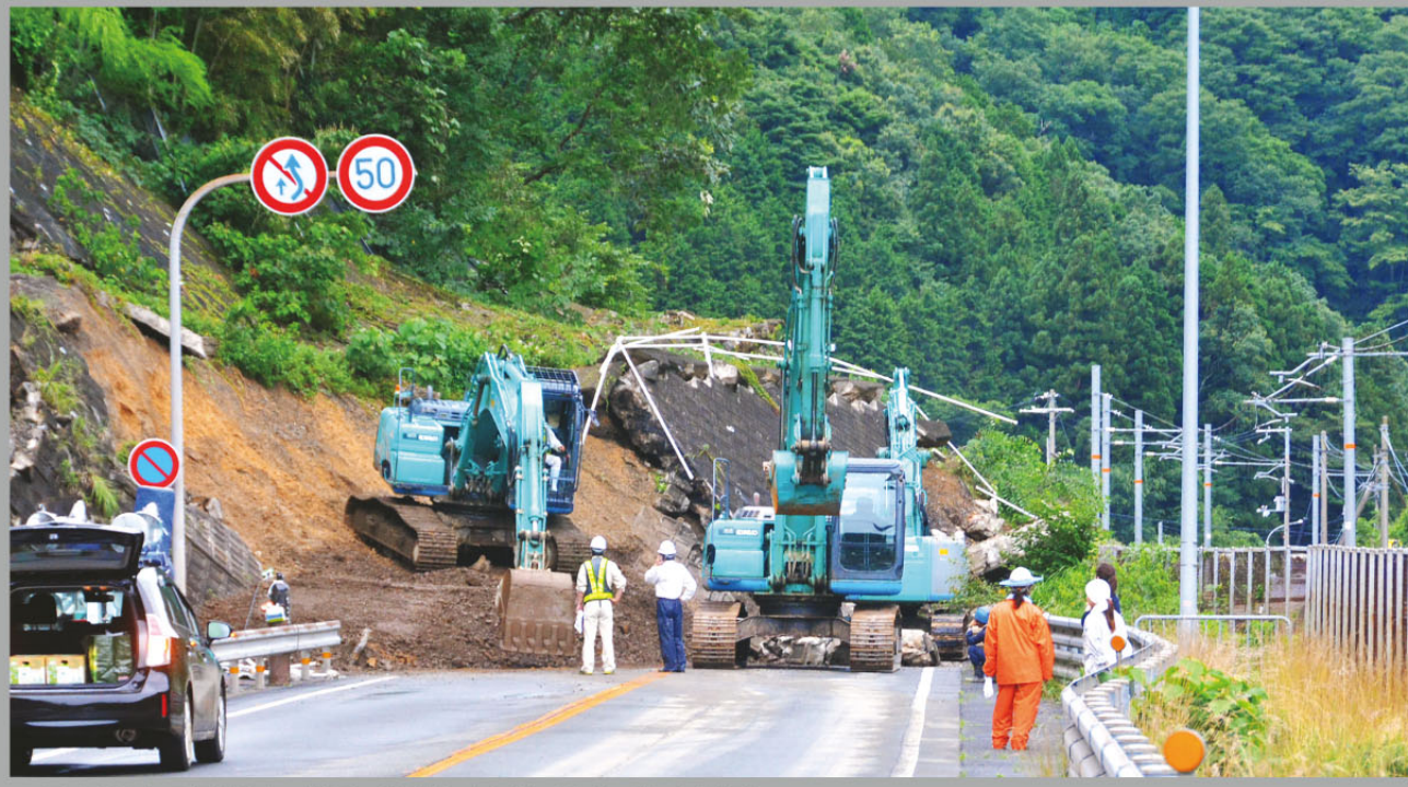
▲平成30年7月豪雨 法面が崩落した国道27号（真倉地区）
