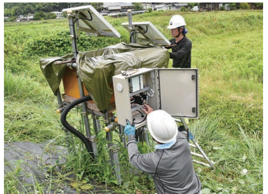
▲水位情報を測定するモニタリング水位計
