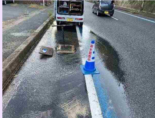
消火栓からの漏水(下福井地区)
