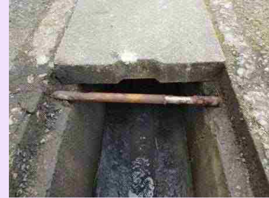
凍結による漏水
