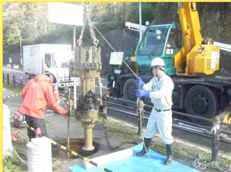
ポンプ場の故障緊急対応
