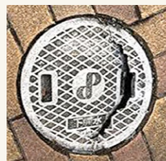
▲壊れた「宅内ます」のフタ
