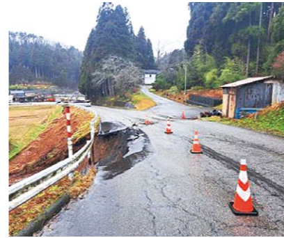
▲陥没した道路
