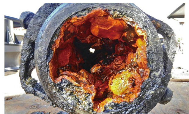
▲老朽化でサビの詰まった水道管
