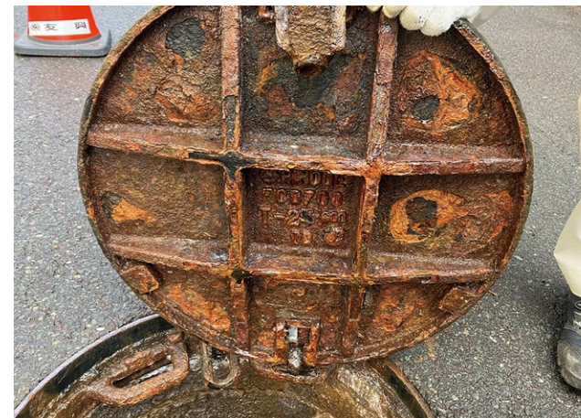
▲腐食し劣化したマンホールのふた
