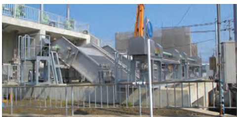
災害に備えて整備が進むポンプ場
