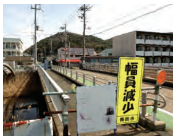
通行止めが続く浪速橋歩道部
