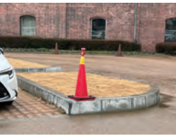
車が接触する危険のある縁石ブロック
